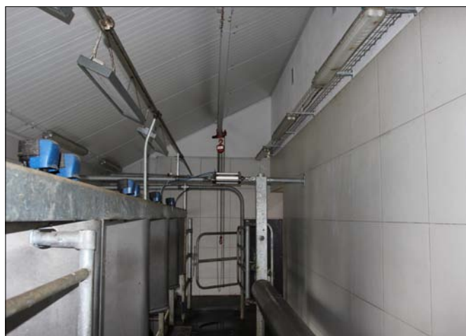
Dojírna na porodně je po celé délce vybavena kolejnicí a zvedákem.
